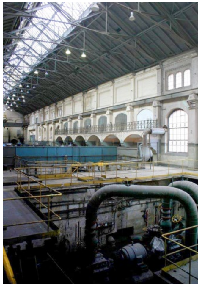
Zabytkowe industrialne wnętrza elektrowni na terenie KOGENERACJI SA.
