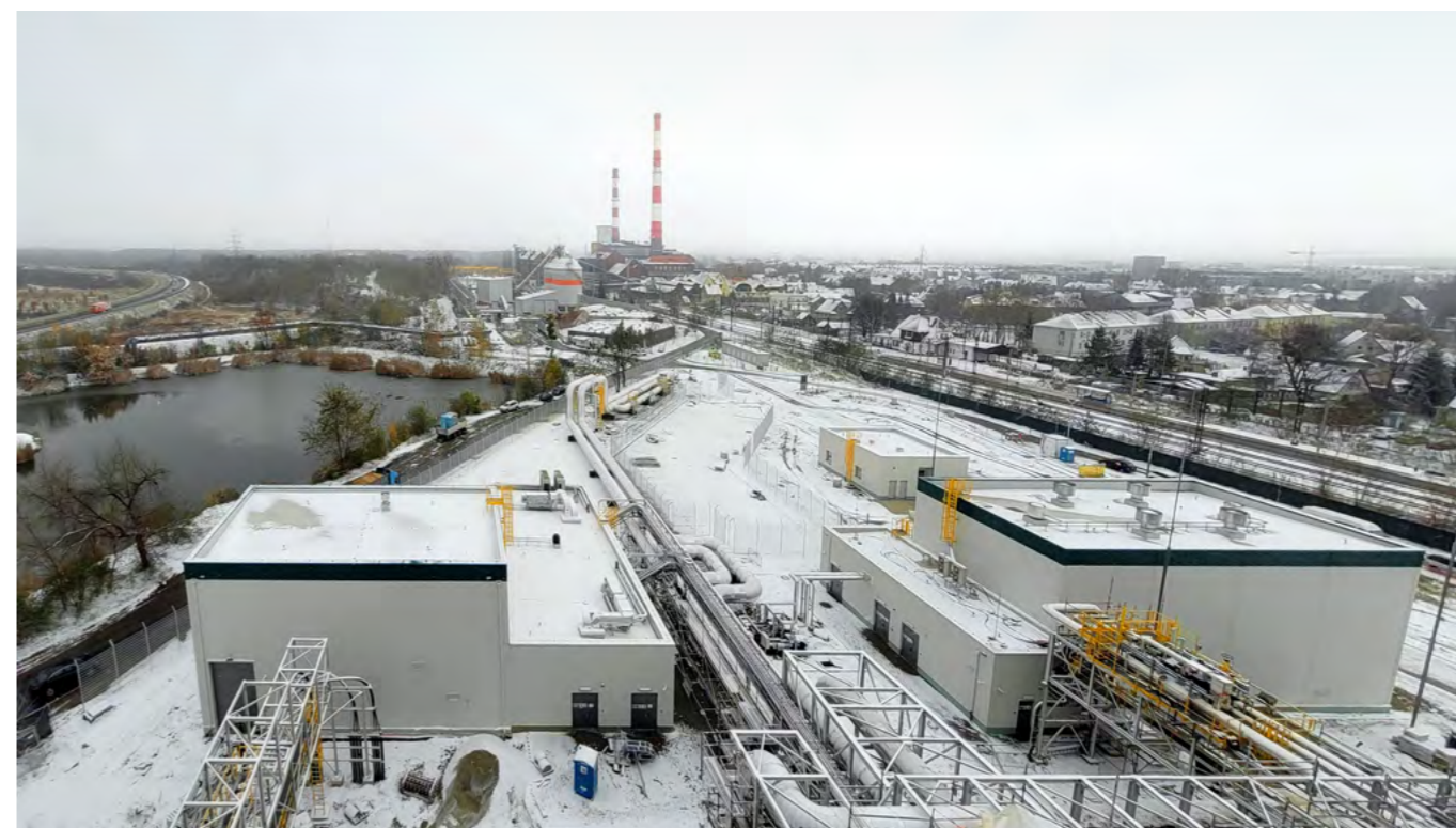
W styczniu budowana w Siechnicach elektrociepłownia gazowa została podłączona do sieci dystrybucji energii.
