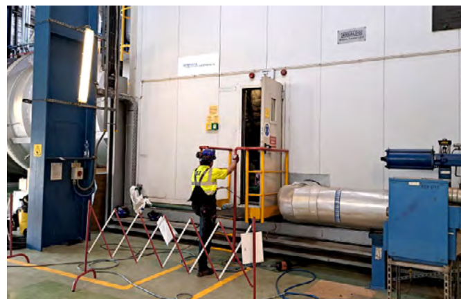
Przebieg remontu bloku gazowo-parowego w Rzeszowie. Przejrzyszli pracownicy w PGE Energia Ciepła Oddział Elektrociepłownia w Rzeszowie.
