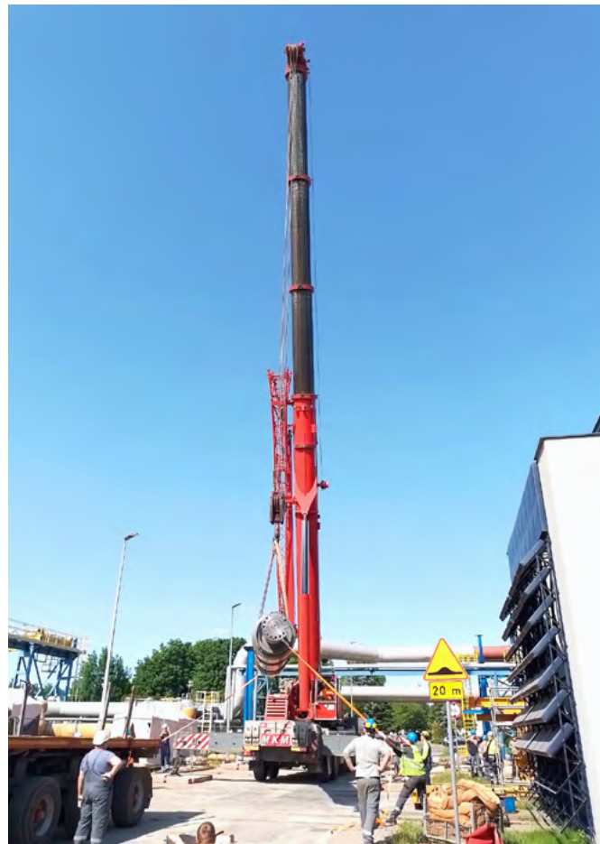
Transport wirnika generatora turbiny gazowej w Lublinie.
