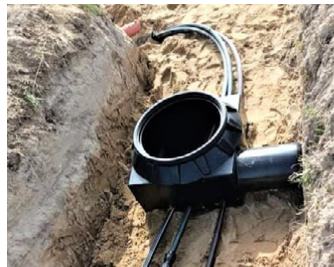
— Do 2028 r. minimum 30 proc. sieci dystrybucyjnej ma zostać skablowana.
