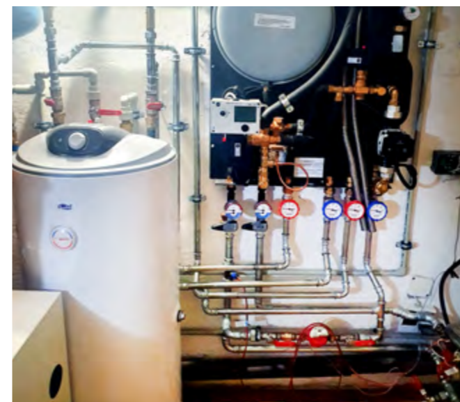
Dostawa i montaż dwufunkcyjnych stacji przymieszkaniowych w budynkach zasilanych z węzła grupowego to jedno z zadań realizowanych dla PGE Toruń.
