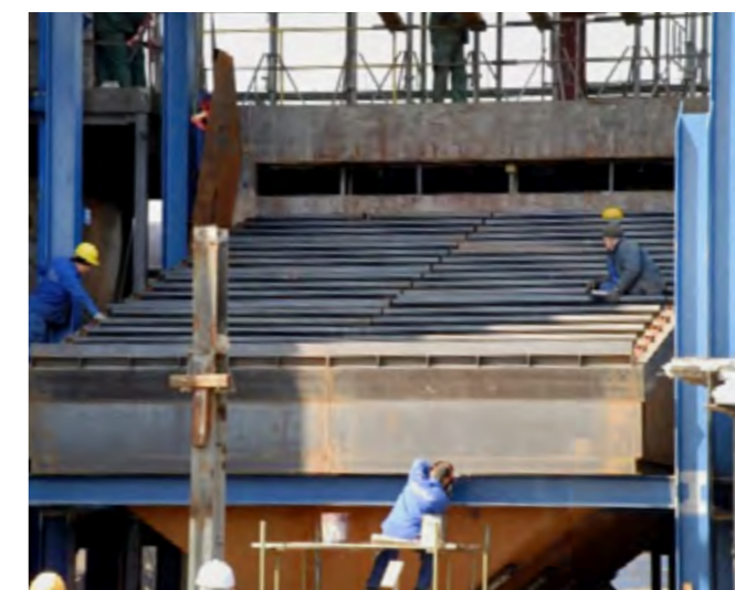
MEGAZEC wykonywał roboty budowlano-montażowe dotyczące odtworzenia rusztu kotła OS20 w elektrociepłowni w Kielcach.
